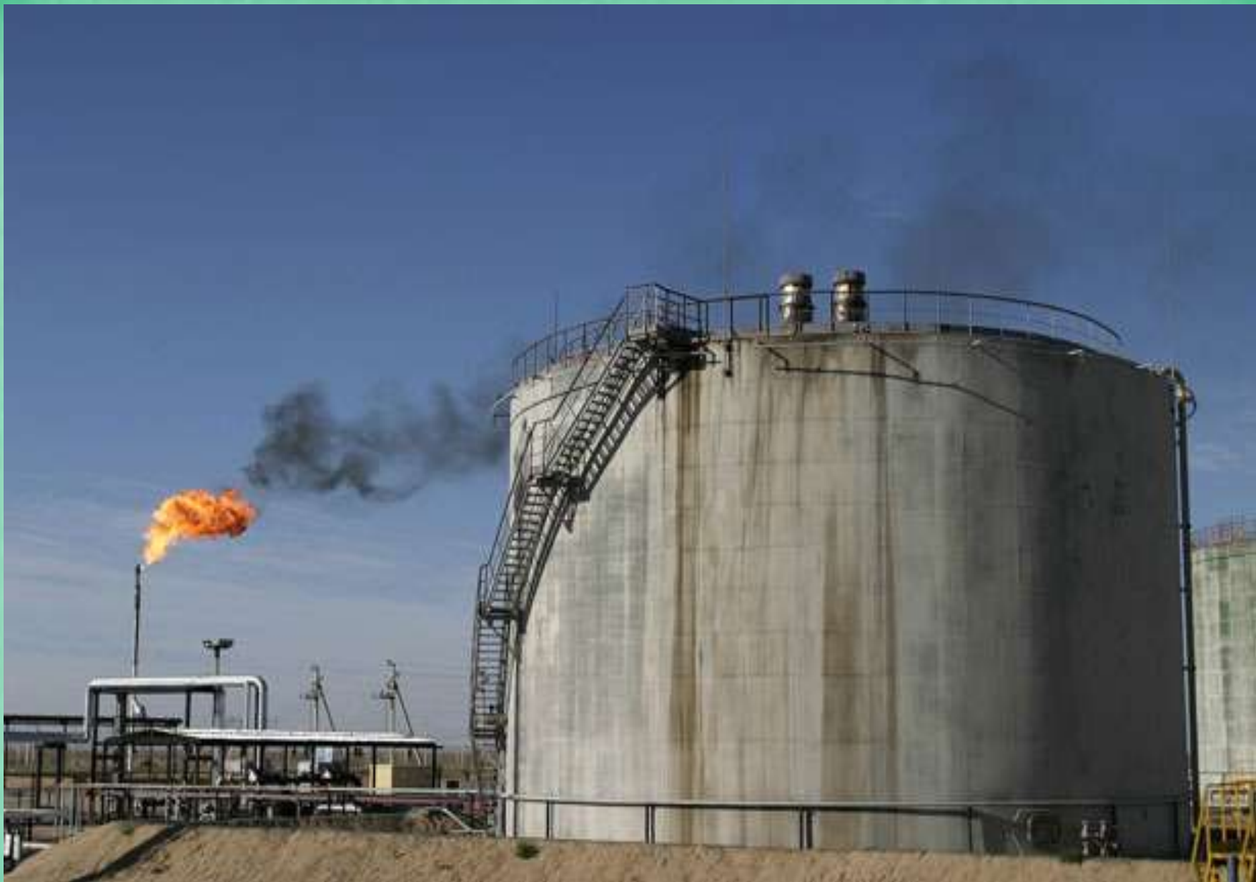
Резервуары для хранения нефти
